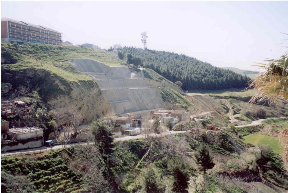
Foto 3. Panoramica del versante in dissesto dell'ex cava, settore meridionale, interessato dai lavori di sistemazione idrogeologica e consolidamento del primo intervento a lavori ultimati da poco (Foto marzo 2004).
