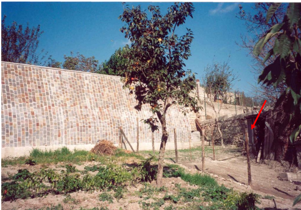
Figura 7. Intervento su Via Forno Vecchio. Vista panoramica dal giardino privato sottostante la strada di un tratto del muro di sostegno su pali eseguito. Il paramento esterno del nuovo muro in c.a. è stato rivestito con lastre di porfido di vari colori, consentendo un discreto inserimento dell'opera nel contesto del paesaggio urbano e agricolo circostante. La freccia rossa sul lato destro indica la posizione del pozzo che è stato utilizzato provvisoriamente per lo smaltimento delle acque captate dal sistema drenante a tergo del muro.
