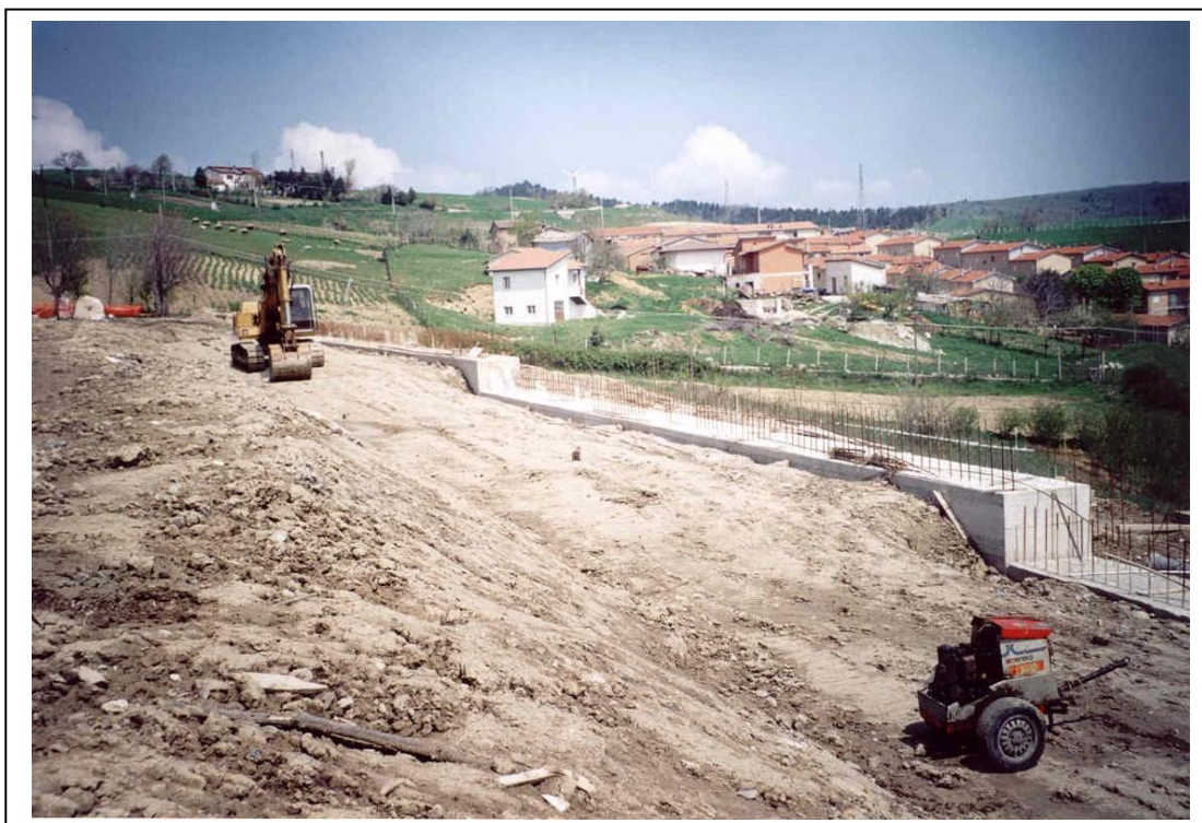
Foto 2. Lavori in corso di costruzione della paratia su pali di grande diametro, tirantata, realizzata in corrispondenza dello spigolo est e sud del campo sportivo (Foto aprile 2002).
