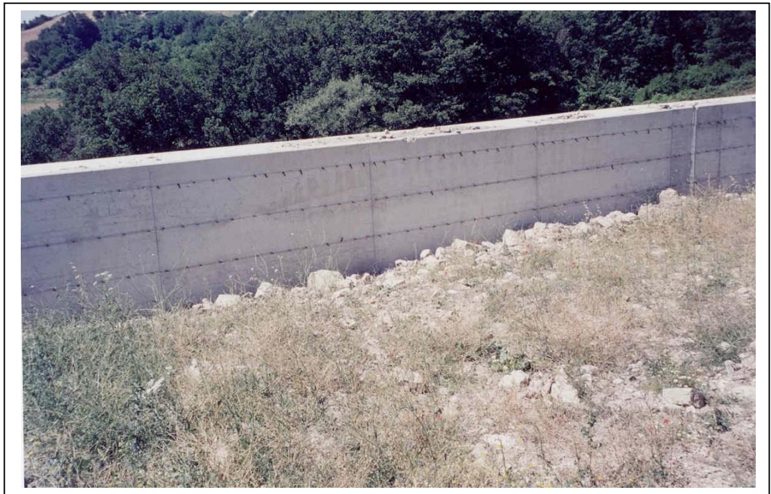
Foto 5. Vista della paratia su pali realizzata sul lato est del campo sportivo, a lavori ultimati e collaudati (Foto luglio 2003)
