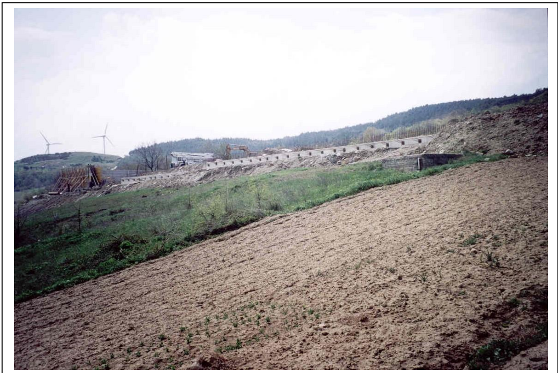
Foto 4. Vista panoramica, dal basso, della paratia su pali, tirantata, sul lato valle, in fase d'esecuzione (aprile 2002).
