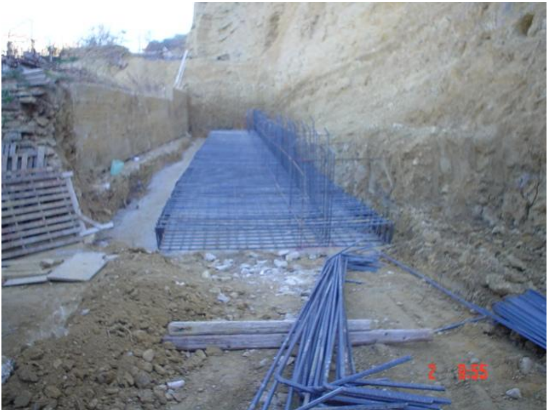
Foto 7: Lavori di costruzione del muro di sostegno in c.a. munito di tiranti d'ancoraggio e con drenaggio retroparete .realizzato alla base del pendio dietro i fabbricati e gli annessi presenti.
