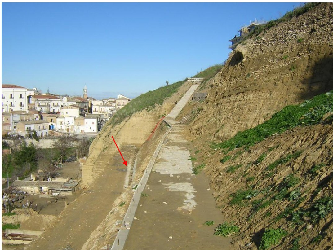
Foto 5: Vista della parte alta del pendio sistemata a gradoni, consolidati con struttura in c.a. ancorata con tiranti, sagomata in modo da fungere da canaletta (freccia rossa) per la raccolta delle acque piovane.
