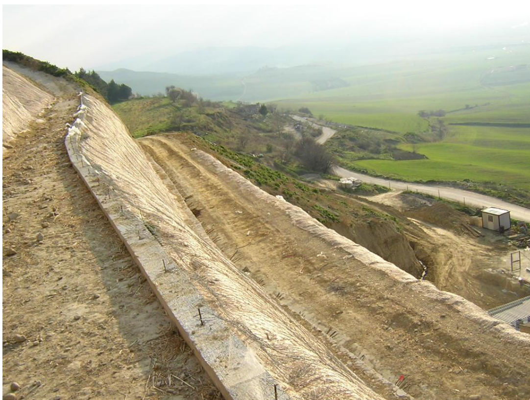
Foto 10: Particolare della sistemazione a gradoni del pendio consolidato e del rivestimento antierosivo delle scarpate del pendio, realizzato con la posa di biostuoia (tipo BIO – MAC) munita di rete metallica ancorata superiormente con picchetti.
