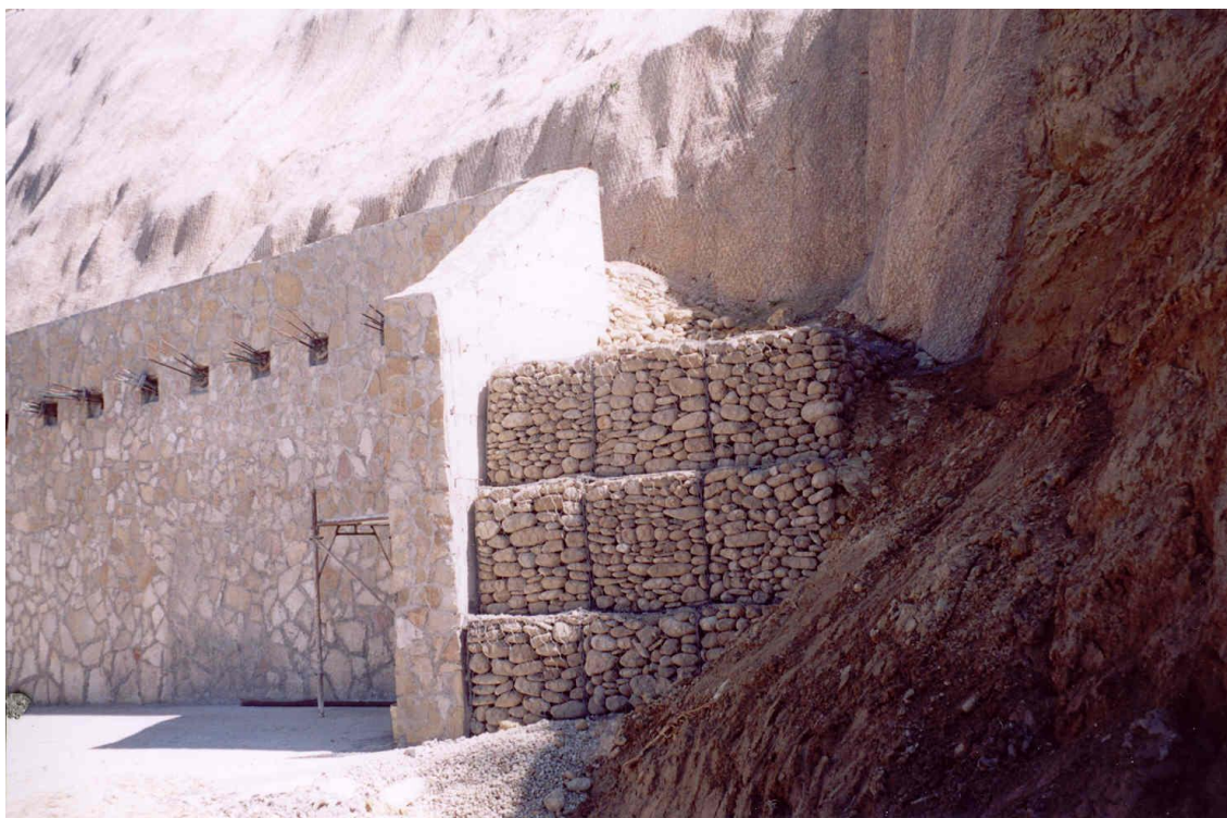
Foto 9: Gabbioni metallicci riempiti con pietrame posti alle due estremità del muro di sostegno in c.a., con alle spalle un sistema drenante. Le acque captate sono poi convogliate a valle nella cunetta laterale della strada comunale per Candela tramite una trincea drenante.
