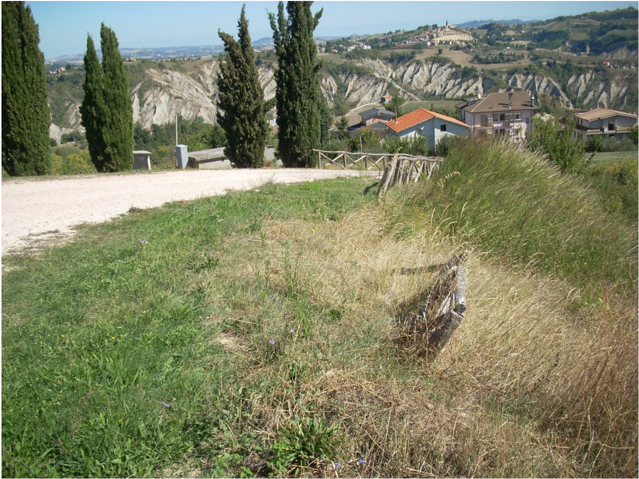
Versante calanchvo antistante il cimitero civico: Staccionata lesionata a seguito del cedimento franoso del terreno.
