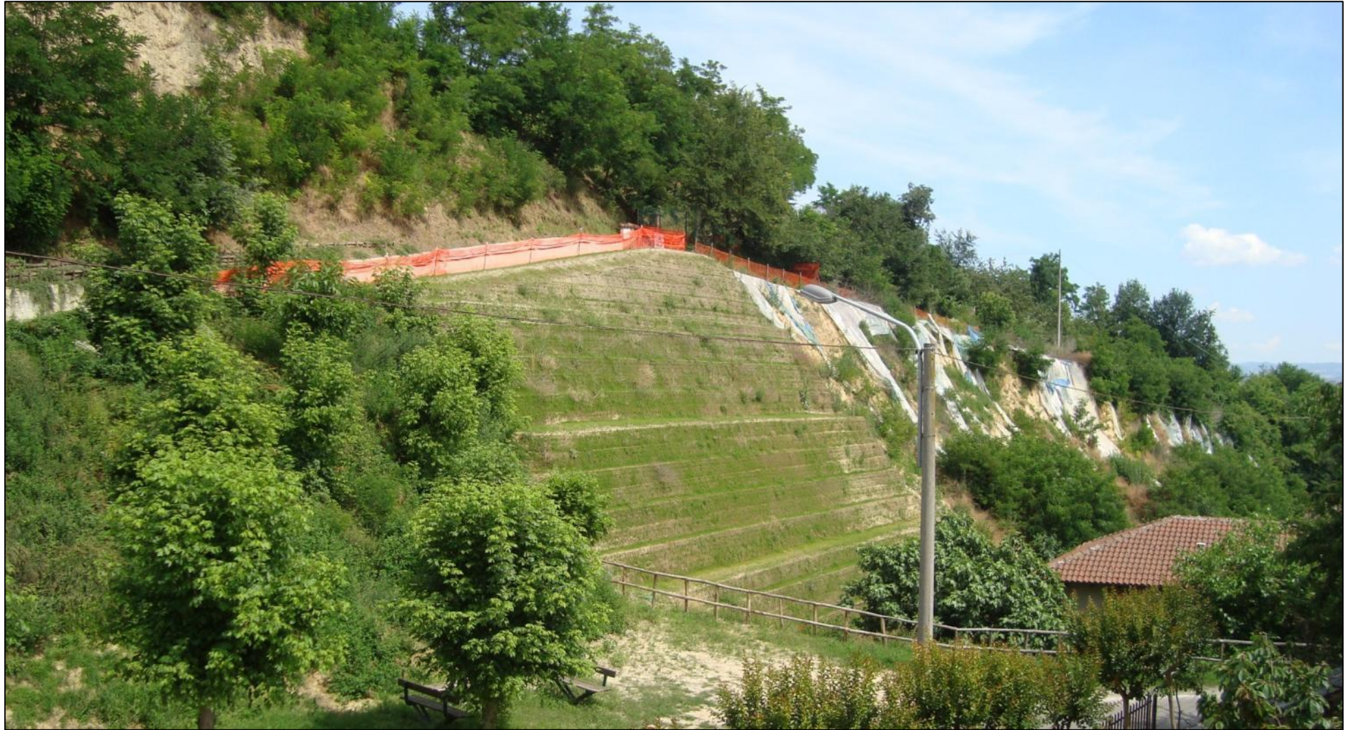
F16 - Vista del fronte del movimento franoso al termine dell'intervento del 1° lotto.
