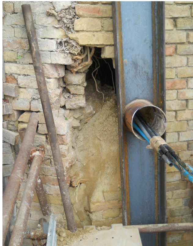
particolare vuoti rinvenuti durante la realizzazione dei tiranti
