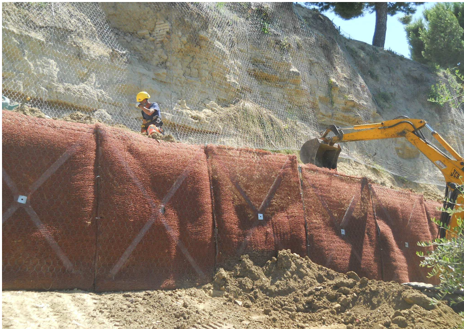
particolare barriere tipo ERDOX e rete metallica di rivestimento scarpata
