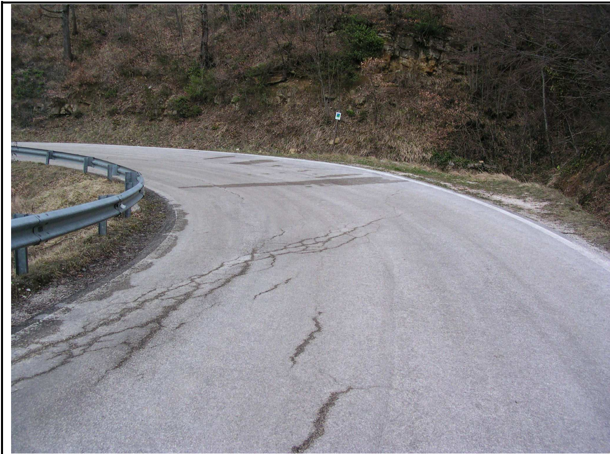
LESIONI STRADA PROVINCIALE PIEVEBOVGLINA - FIASTRA
