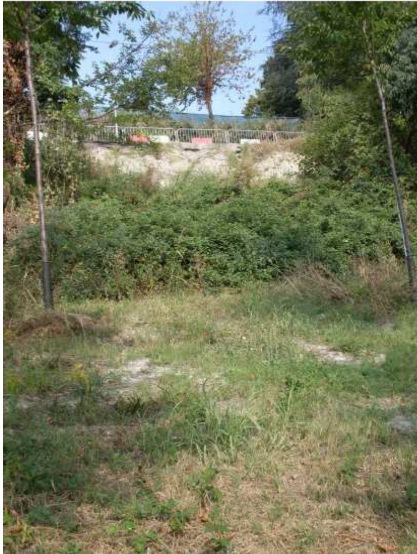
Foto 7 – Settembre 2009. Vista di valle del dissesto lungo la Sp 118 dir. Dall'alto verso il basso si vedono: la perimetrazione del dissesto effettuata lungo la SP 118 dir la nicchia e il coronamento della frana, la zona d'accumulo già rivegetata da rovi ed essenze locali infestanti e sistemata presso la rottura di pendenza della scarpata stradale, il pendio a valle della scarpata stradale.
