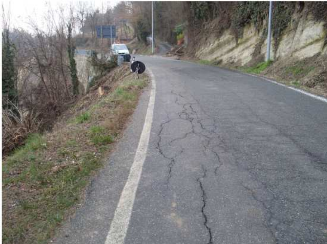
Foto n. 1 – Gennaio 2009. Prime evidenze della criticità della scarpata Sp 118 dir km 1+700. Apposizione di opportuna segnaletica di pericolo. Dai rilevamenti emerge che il dissesto coinvolge i materiali di copertura.
