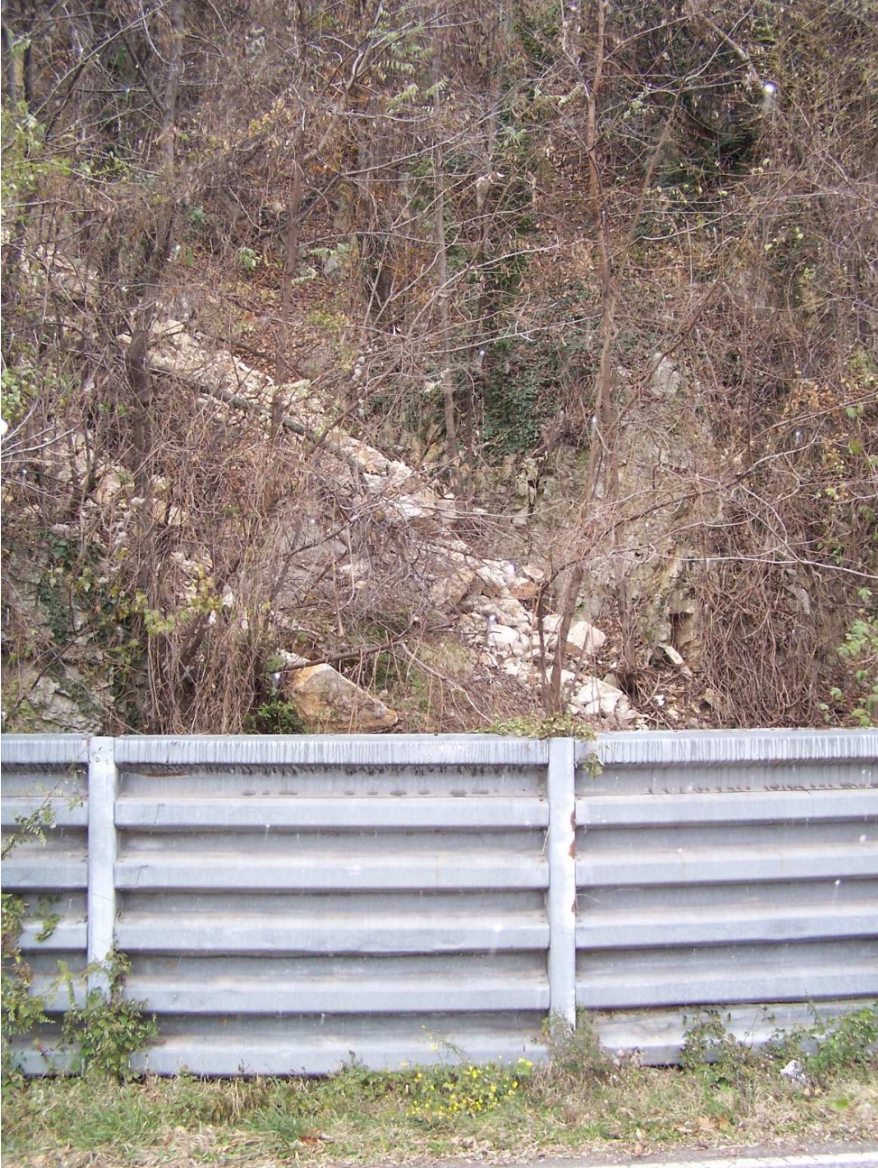
Fotografia n. 18 – Particolare barriera paramassi da sostituire
