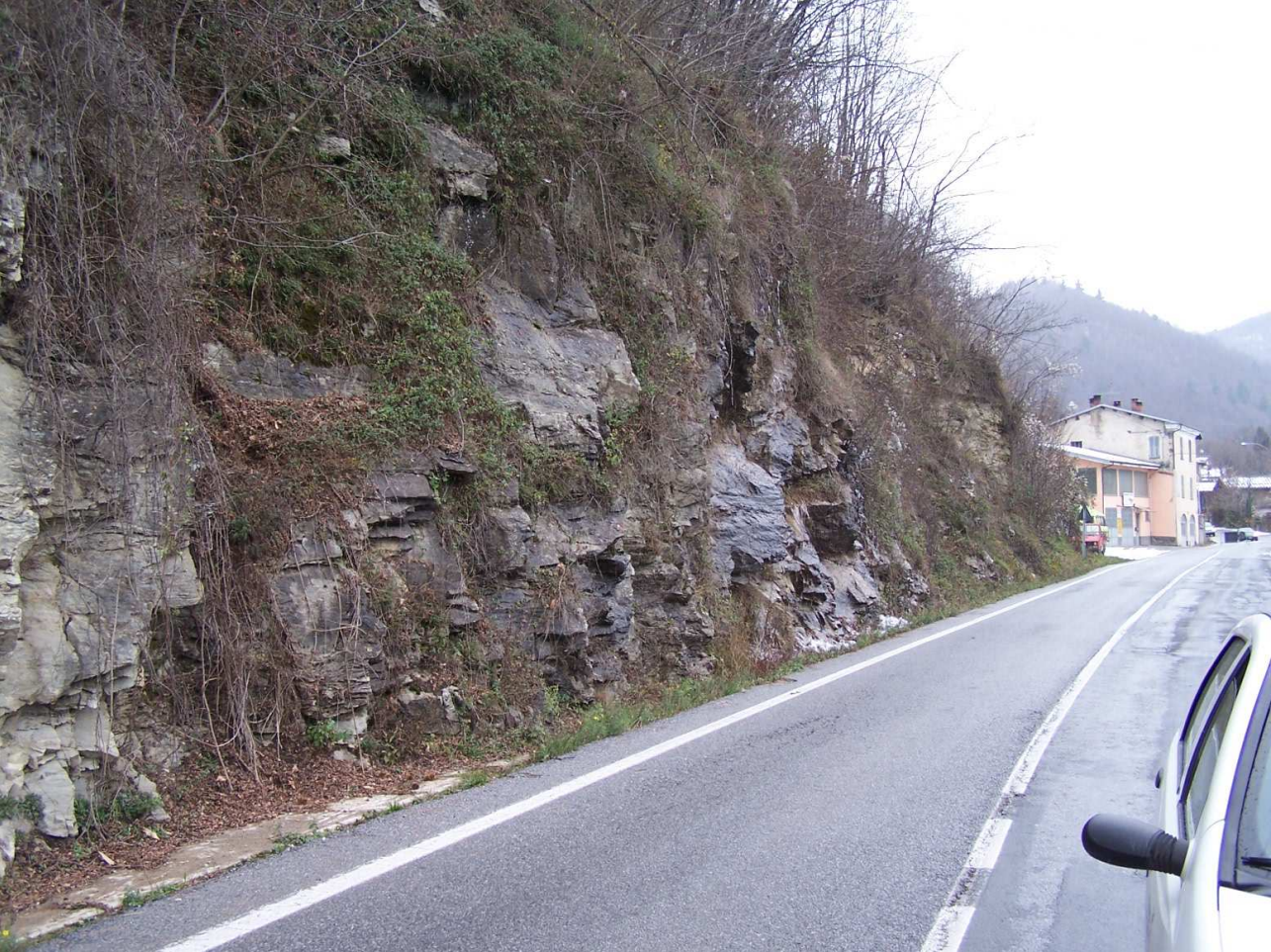
Fotografia n. 20 – Tratto sul quale è necessario intervenire con un consolidamento mediante opere di protezione
