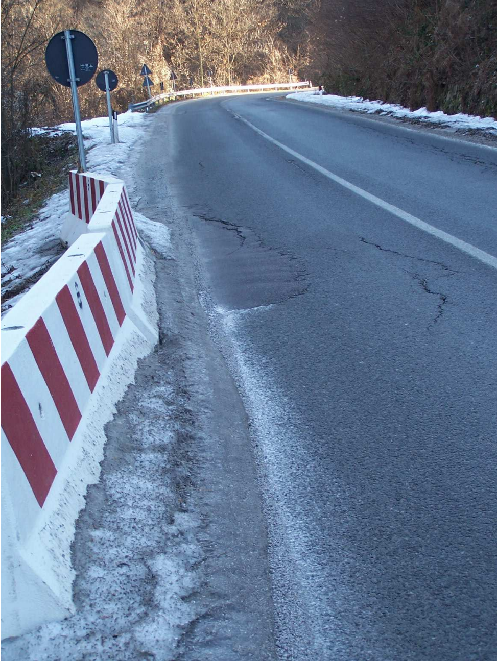
Fotografia n. 5 – Particolare cedimento sul corpo stradale
