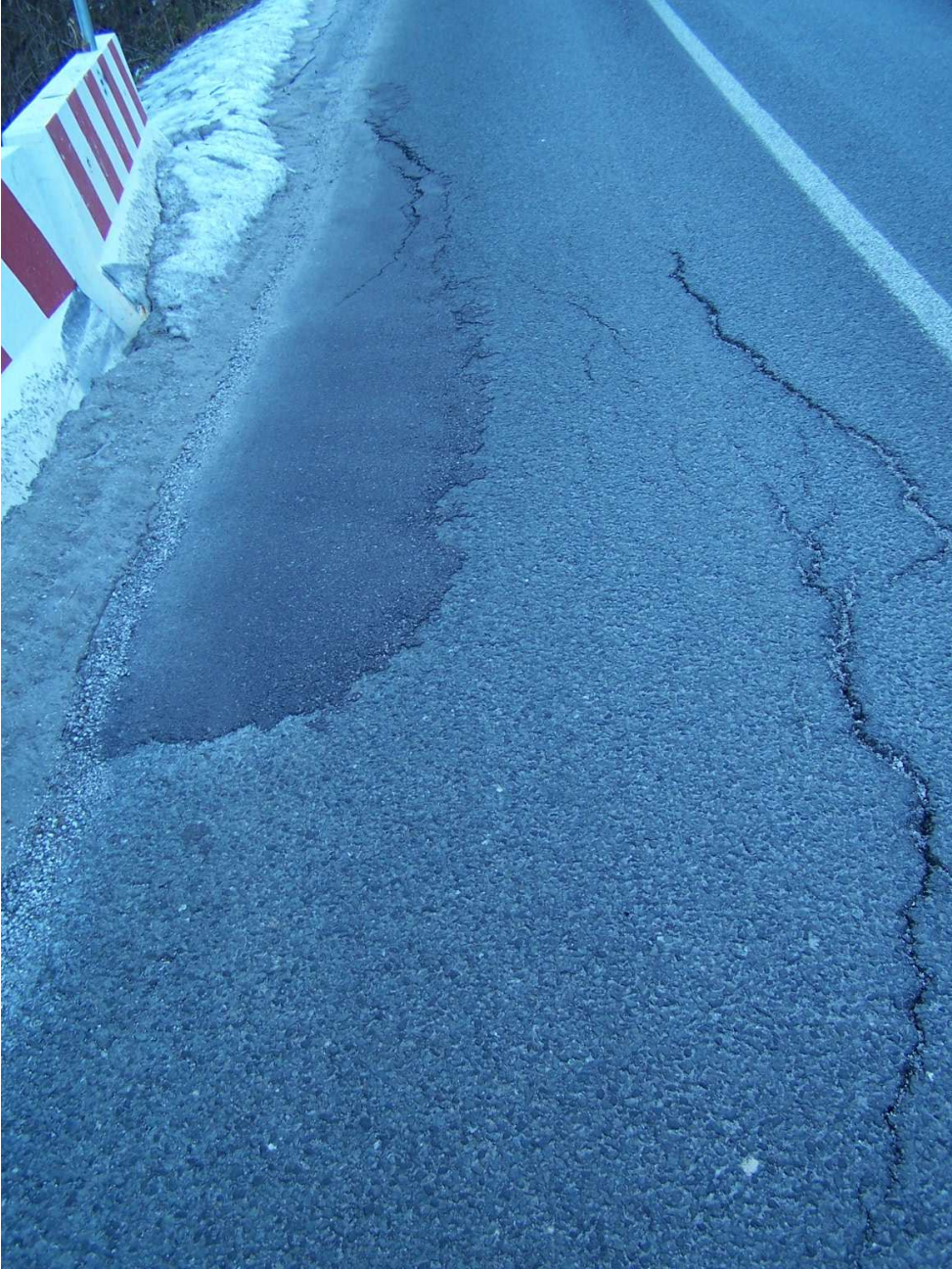
Fotografia n. 8 – Cedimento corpo stradale
