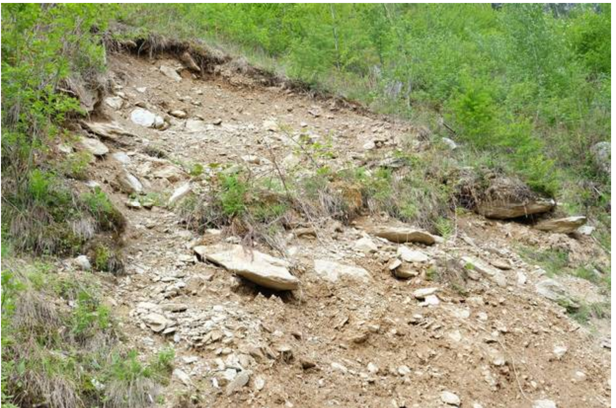
Intervento 7: SIF Frana strada Tajade 2
