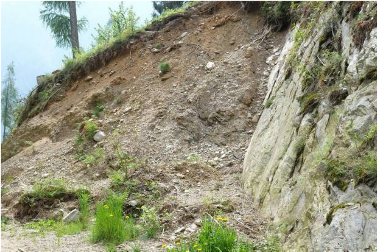
Intervento 6: SIF Frana strada Tajade 1
