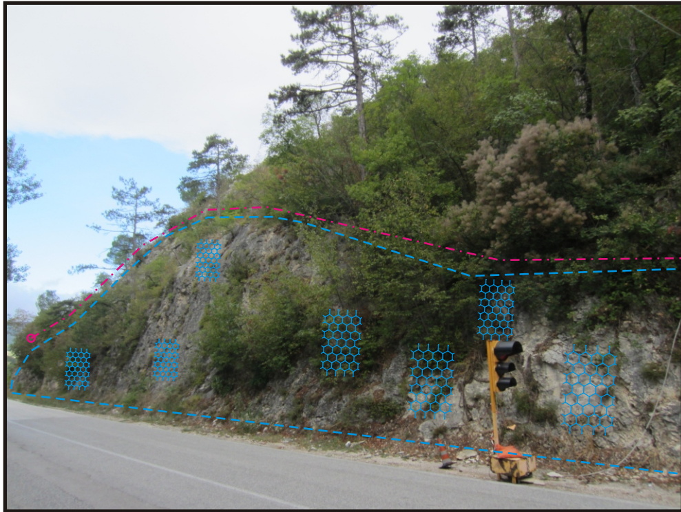
Fot.3 - Ispezione di parete rocciosa e disaggio di masse rocciose pericolanti + rivestimento corticale delle pareti rocciose con Rete paramassi metallica a maglia esagonale 8 x 10 cm. In sommità del ciglio di scarpata stradale ubicazione di max della BARRIERINA DI PROTEZIONE STRADALE da collocarsi in più tratti discontinui con bordi sovrapposti
