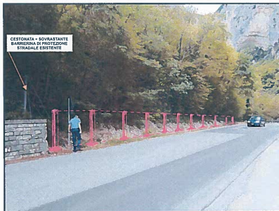
Fot.7 - ubicazione di max della BARRIERINA DI PROTEZIONE STRADALE da collocarsi in più tratti discontinui con bordi sovrapposti
