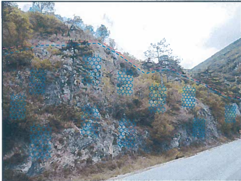
Fot.2 - Ispezione di parete rocciosa e disgreggio di masse rocciose pericolanti + rivestimento corticale delle pareti rocciose con Rete paramassi metallica a maglia esagonale 8 x 10 cm. In sommità del ciglio di scarpata stradale ubicazione di max della BARRIERINA DI PROTEZIONE STRADALE da collocarsi in più tratti discontinui con bordi sovrapposti
