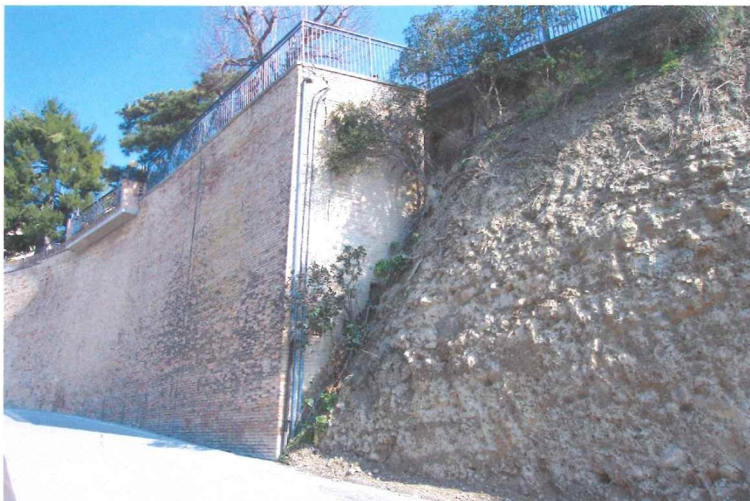
Foto n.3: Fotografia scattata da Sud-Est. L'immagine mostra il muro realizzato negli anni passati e che dovrà essere prolungato per la salvaguardia della scuola elementare e della strada provinciale.
