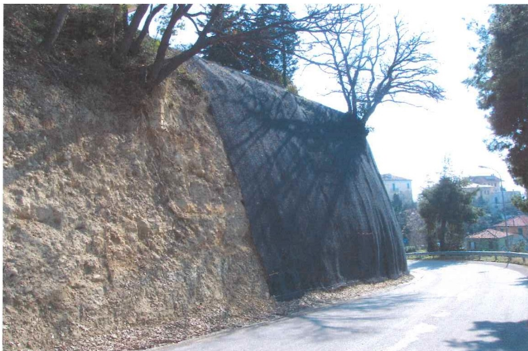
Foto n.4: Fotografia scattata da Nord-Ovest. L'immagine mostra l'intervento provvisorio di somma urgenza eseguito dalla provincia di Ascoli Piceno per contrastare i continui movimenti franosi che hanno interessato la strada a partire dal mese di dicembre 2004 in concomitanza di eventi meteorici eccezionali.
