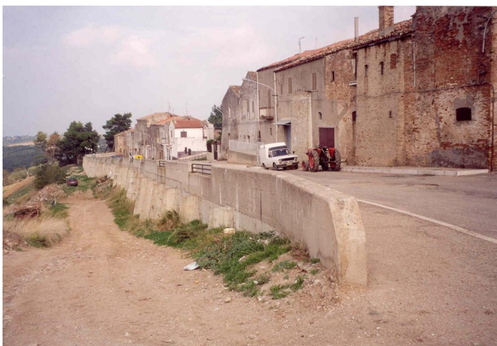
Foto 6. Panoramica del vecchio muro con speroni in calcestruzzo, realizzato a sostegno di Via Fani dal Genio Civile, dissestato ed a rischio di crollo in più punti. (Foto novembre 2001)
