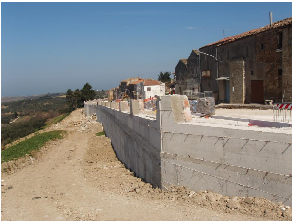
Foto 5. Panoramica del tratto di muro di sostegno in c.a. su pali realizzato nell'intervento in esame in aderenza al vecchio muro con speroni in calcestruzzo, al quale è collegato tramite contrafforti. (Foto marzo 2005)
