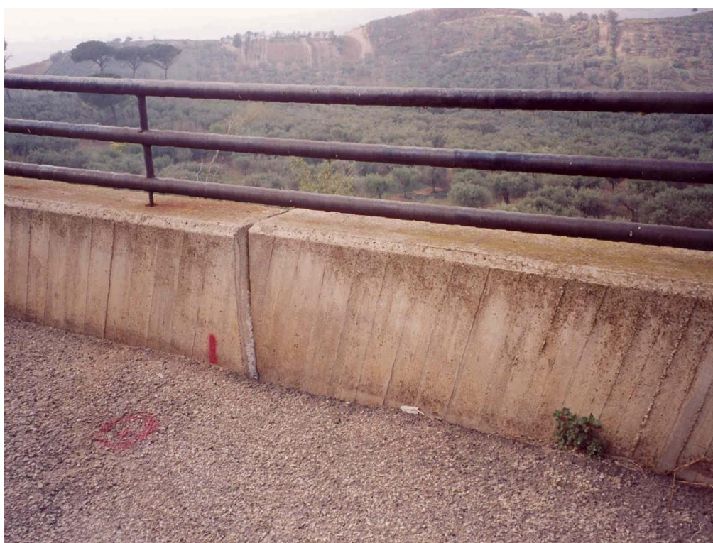
Foto 4. Particolare dei fenomeni di roto - traslazione del vecchio muro di contenimento con speroni in calcestruzzo realizzato a valle di Via Fani (Foto novembre 2001).
