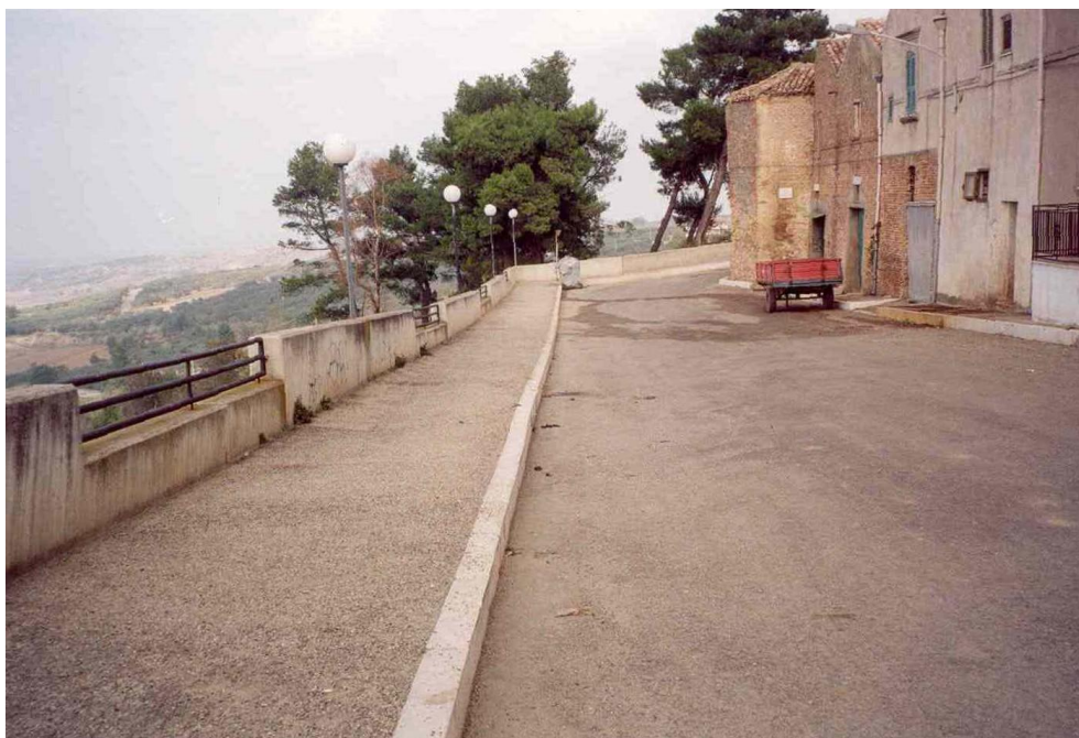
Foto 3. Panoramica di Via Martiri di Via Fani, interessata da gravi fenomeni di dissesto, prima degli interventi di consolidamento e di sistemazione idrogeologica dell'area (Foto novembre 2001)
