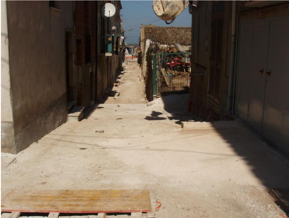
Foto 9. Panoramica dei lavori in corso di sistemazione idraulica e rifacimento delle pavimentazioni stradali dissestate lungo Via Italia. Lungo questa strada è stato già realizzato un nuovo tronco di fogna bianca (Foto marzo 2005)
