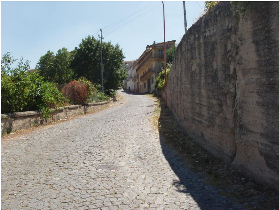
Fig. 5. Via Le Cesi: Panoramica della sede stradale e del muro di sostegno sul lato monte dissestati (foto agosto 2008)
