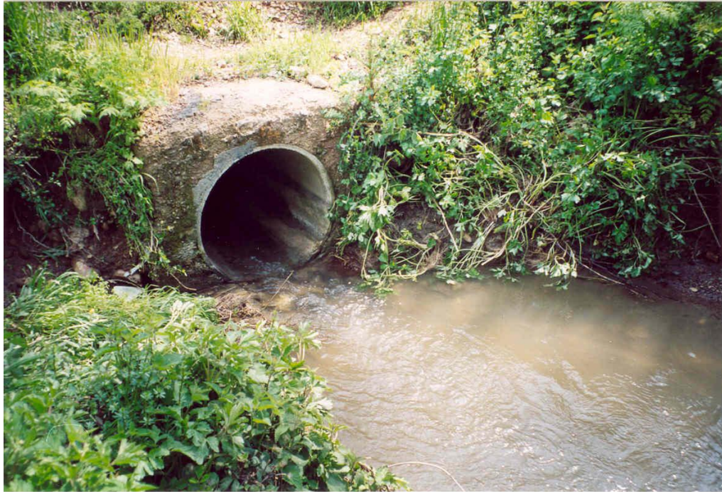
Foto 5. Particolare dello sbocco dello sbocco dell'attraversamento del torrente Fiumarella da parte della strada Costa Fra Lazzaro, realizzato mediante un manufatto in calcestruzzo con tubazione in calcestruzzo prefabbricato, prima del completamento dei lavori di sistemazione e consolidamento dell'area (maggio 2002).
