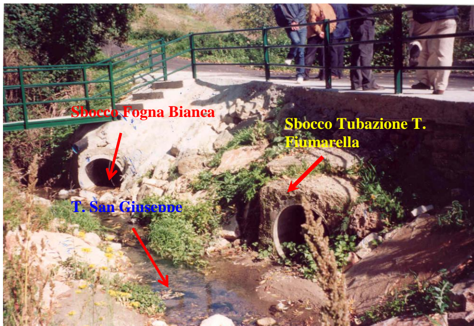
Foto 6. Vista panoramica, a lavori ultimati (ottobre 2002) della passerella metallica realizzata in corrispondenza del punto di confluenza del torrente San Giuseppe con il torrente Fiumarella. Visibile, sotto la passerella, anche lo sbocco della tubazione della fogna bianca urbana.
