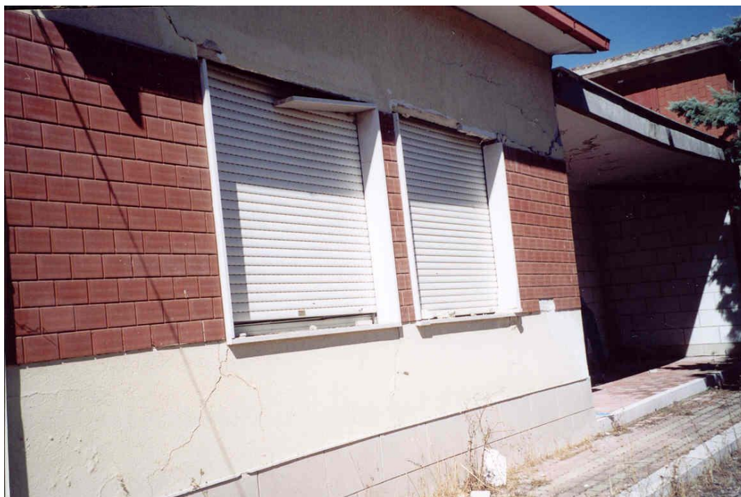
Foto 2. Edificio della ex scuola materna "S. Giovanni bosco" gravemente dissestato e pericolante. Il complesso è stato demolito dopo il terremoto dell'ottobre 2002 e l'area è stata oggetto di lavori di sistemazione con la perizia di variante (Foto settembre 2001).
