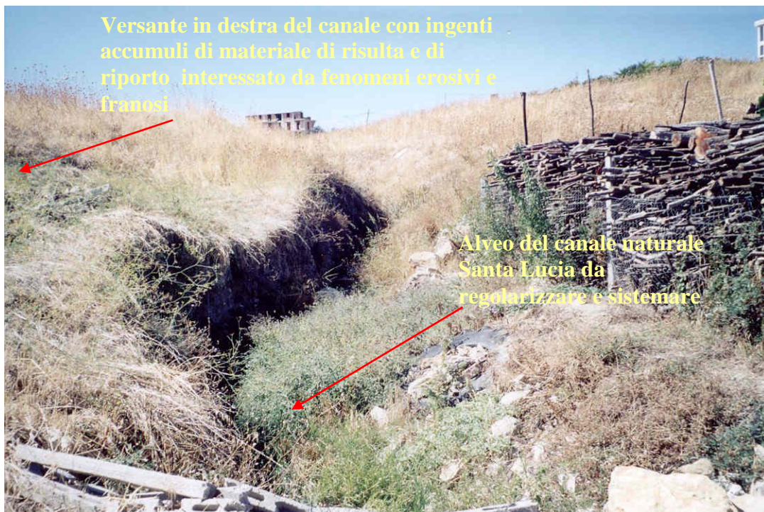
Foto 1: Panoramica del tratto del vallone del Canale Santa Lucia in stato di grave degrado ambientale prima dell'intervento di sistemazione e risanamento dei dissesti (Foto settembre 2001).
