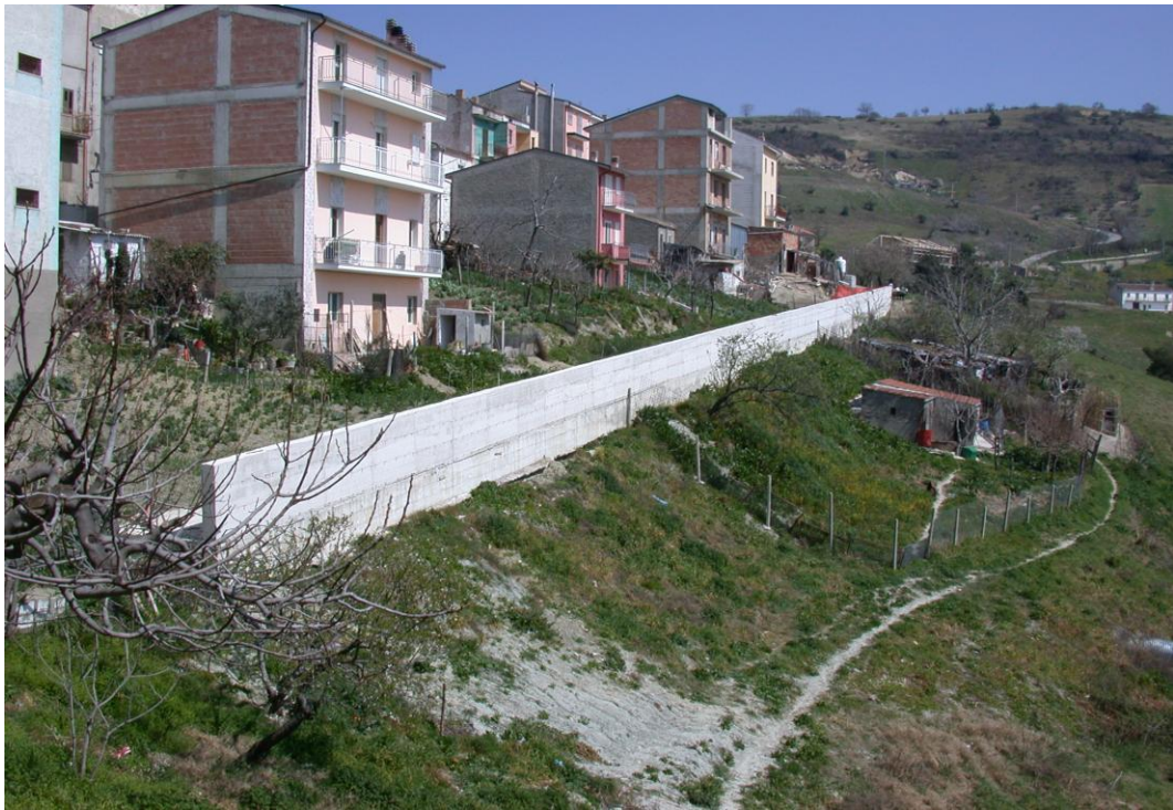
Figura 7: Vista panoramica, a lavori in fase d'ultimazione (foto di Aprile 2003), della parte alta del pendio interessata dall'intervento: la paratia è stata completata così come la strada di penetrazione a monte della stessa, il muretto di contenimento in c.a. ed il pozzetto di raccolta.
