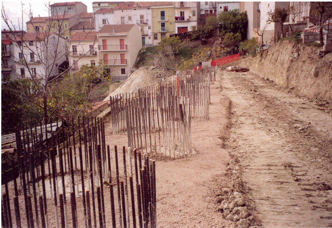
Figura 6: Particolare della testa dei pali di grande diametro della paratia: i pali sono disposti a quinconce. Sulla trave di collegamento in testa dei pali è stato realizzato un muro di contenimento in c.a. (foto di Novembre 2001).
