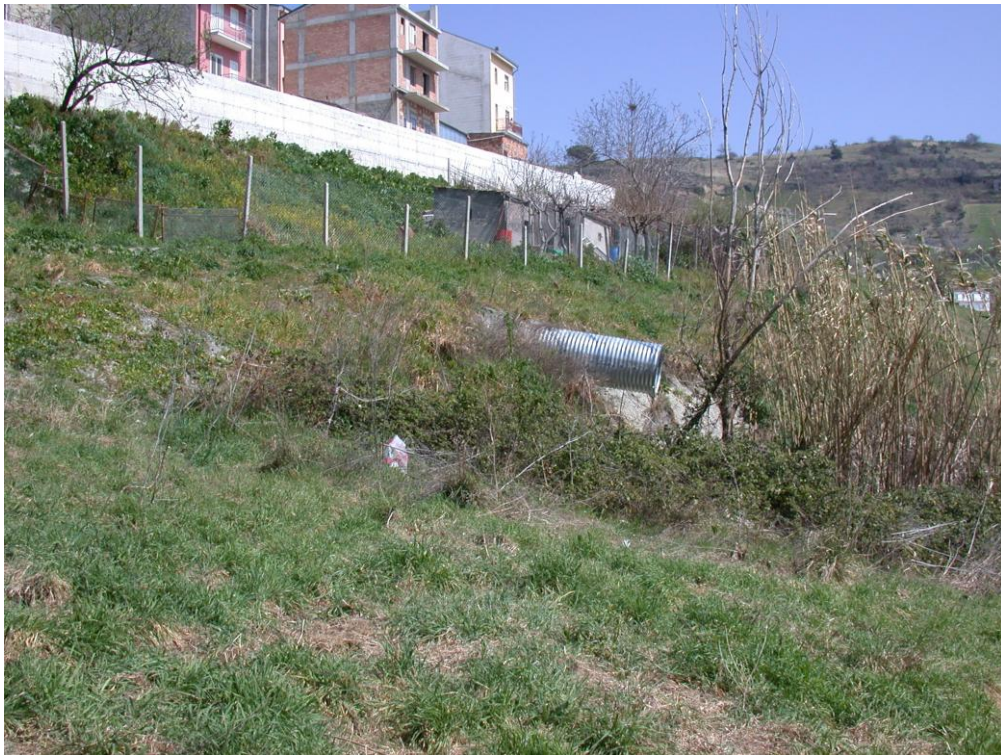
Figura 9: Particolare dello sbocco della tubazione in acciaio zincato di scarico delle acque nel fosso. Con la Perizia di Variante la lunghezza della tubazione è stata aumentata per evitare fenomeni di erosione e scalzamento nel pendio alla base della paratia (foto di Aprile 2003).
