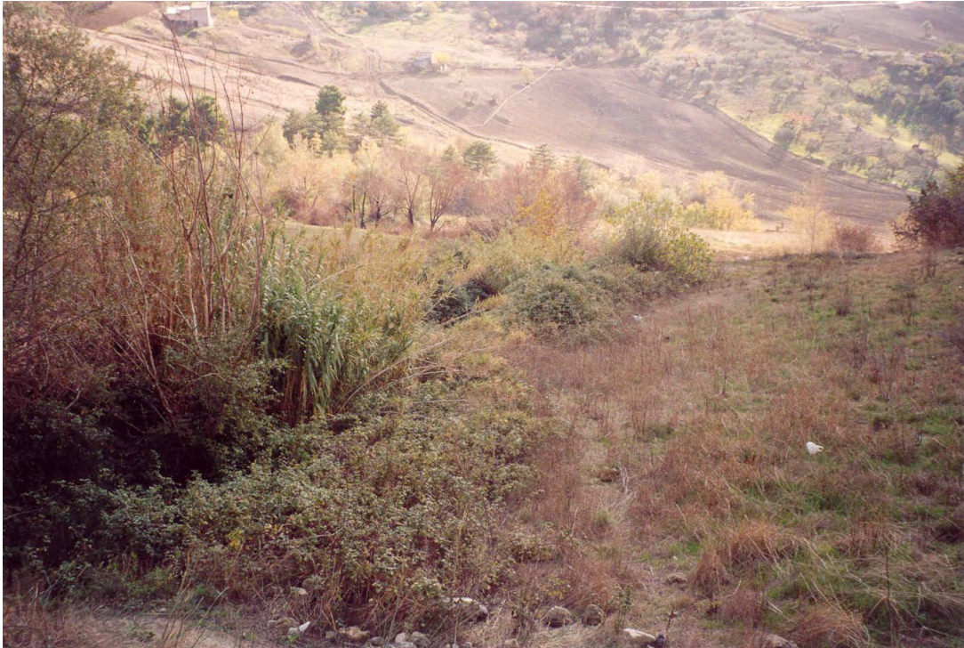
Figura 2: Fosso in approfondimento nel pendio sottostante la paratia di pali realizzata a sostegno dei fabbricati di Via Trento. Il fosso funge da collettore per le acque drenate e per quelle meteoriche provenienti dalle zone a monte dell'abitato. E' prevista la sistemazione idrogeologica con interventi di pulizia, regolarizzazione alveo e briglie
