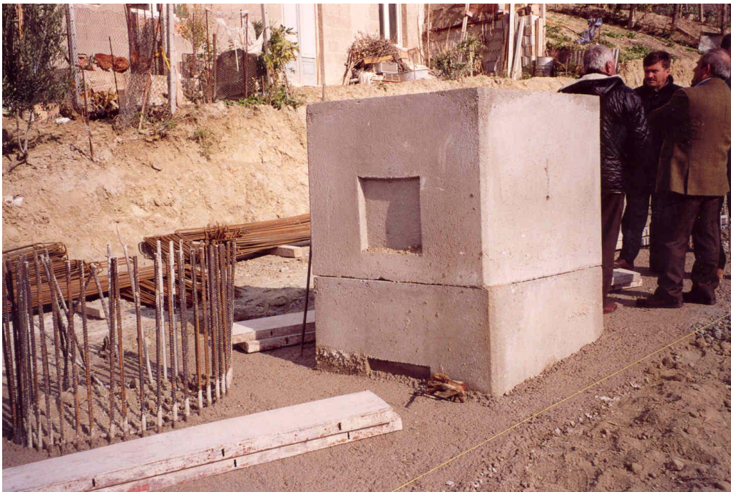
Figura 10: Pozzetto di raccolta delle acque di drenaggio e di quelle piovane provenienti dalle zone a monte dell'abitato, ubicato a ridosso del costruendo muretto in c.a. su paratia. Le acque sono convogliate, tramite tubazione in acciaio zincato, nel fosso da sistemare a valle della paratia. (foto di Novembre 2001)
