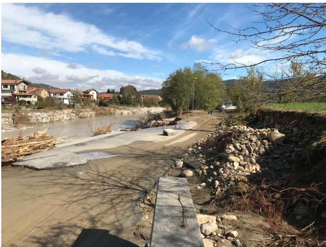
Fotografia n. 7 – Vista sponda dx a valle del ponte Romano con erosione terreno a lato della strada
