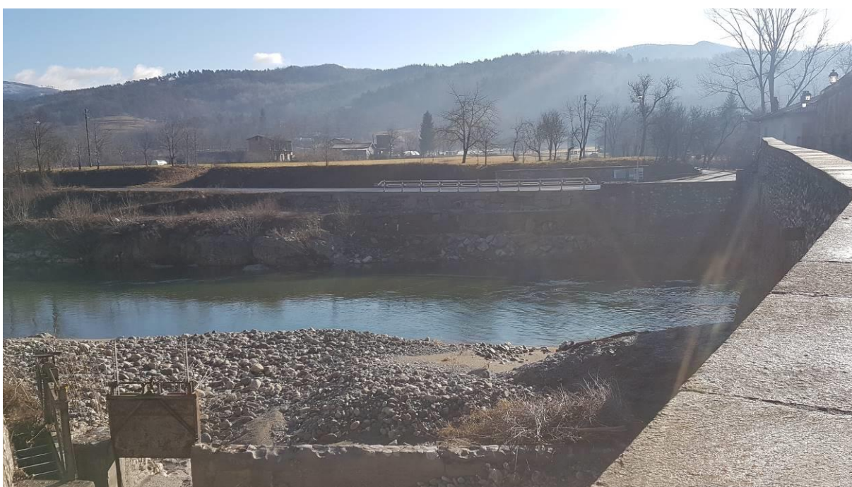
FOTO n. 12 - Vista frontale a valle del Ponte Romano con ammasso roccioso in da eliminare
