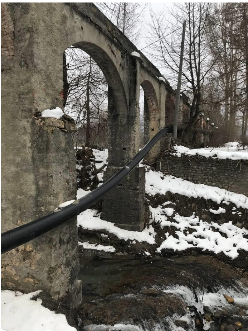
Fotografia n. 8 – Vista dei piloni del ponte da rinforzare con la tubazione dell'acquedotto caduta a seguito dell'alluvione.
