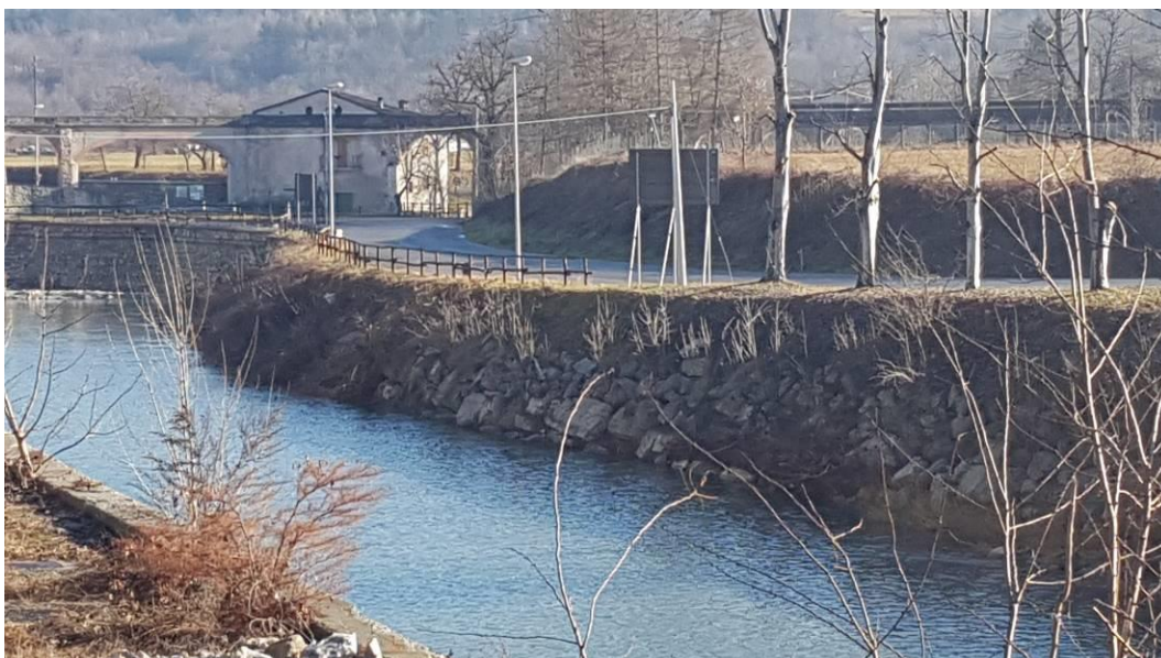
Fotografia n. 16 - Vista da monte dell'area a dx Tanaro con il terreno da asportare a livello stradale con aggiramento della casa esistente
