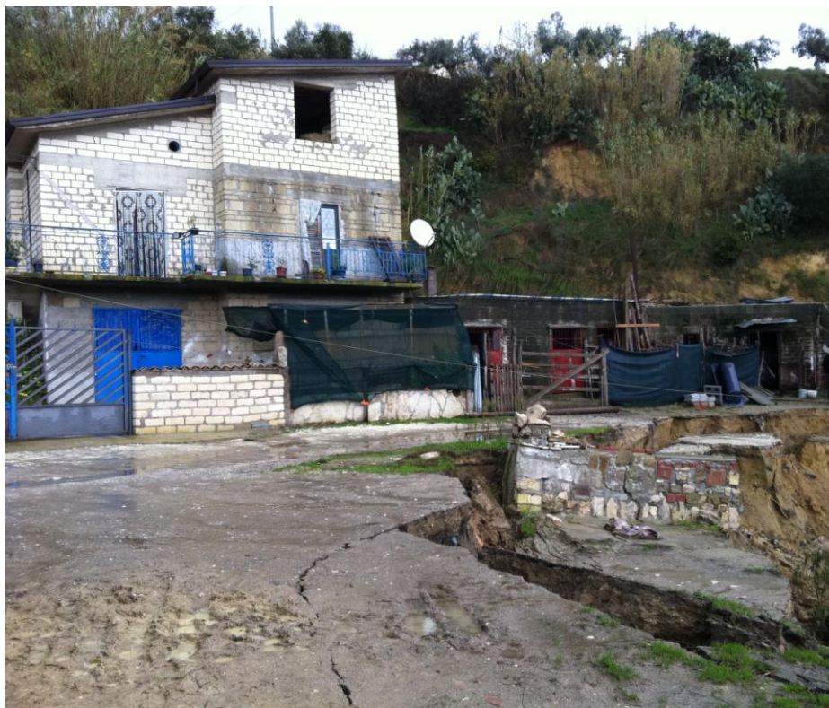
FOT. N. 5: FRANA A RIDOSSO DEI FABBRICATI
