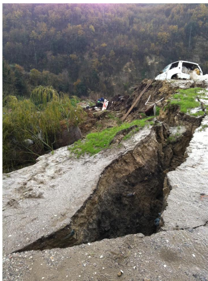
FOT. N. 2: FRANA A RIDOSSO DEI FABBRICATI
