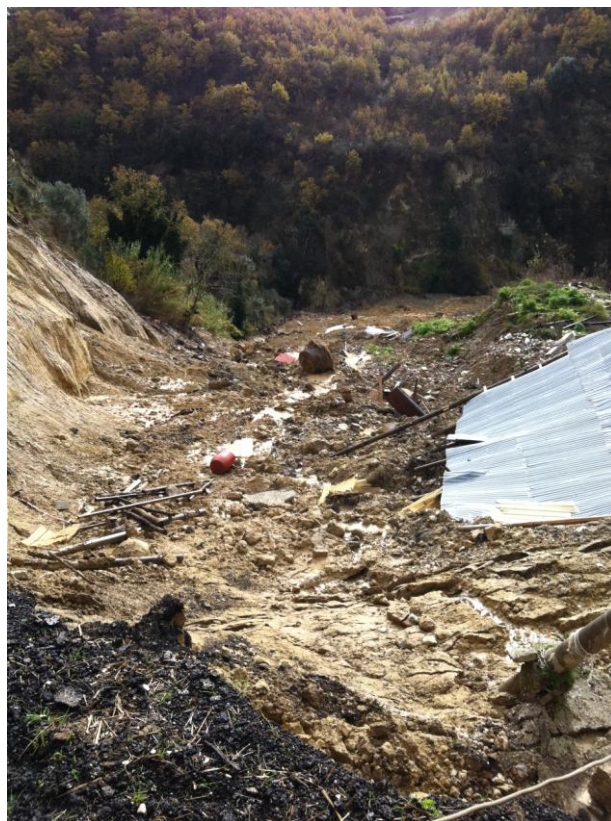
FOT. N. 3: PANORAMICA CORPO DI FRANA
