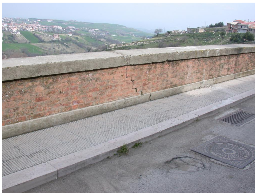
Foto 4. Particolare dei dissesti statici che interessano la sede stradale di via Ripa Cavallina ed il vecchio muro di sostegno.
