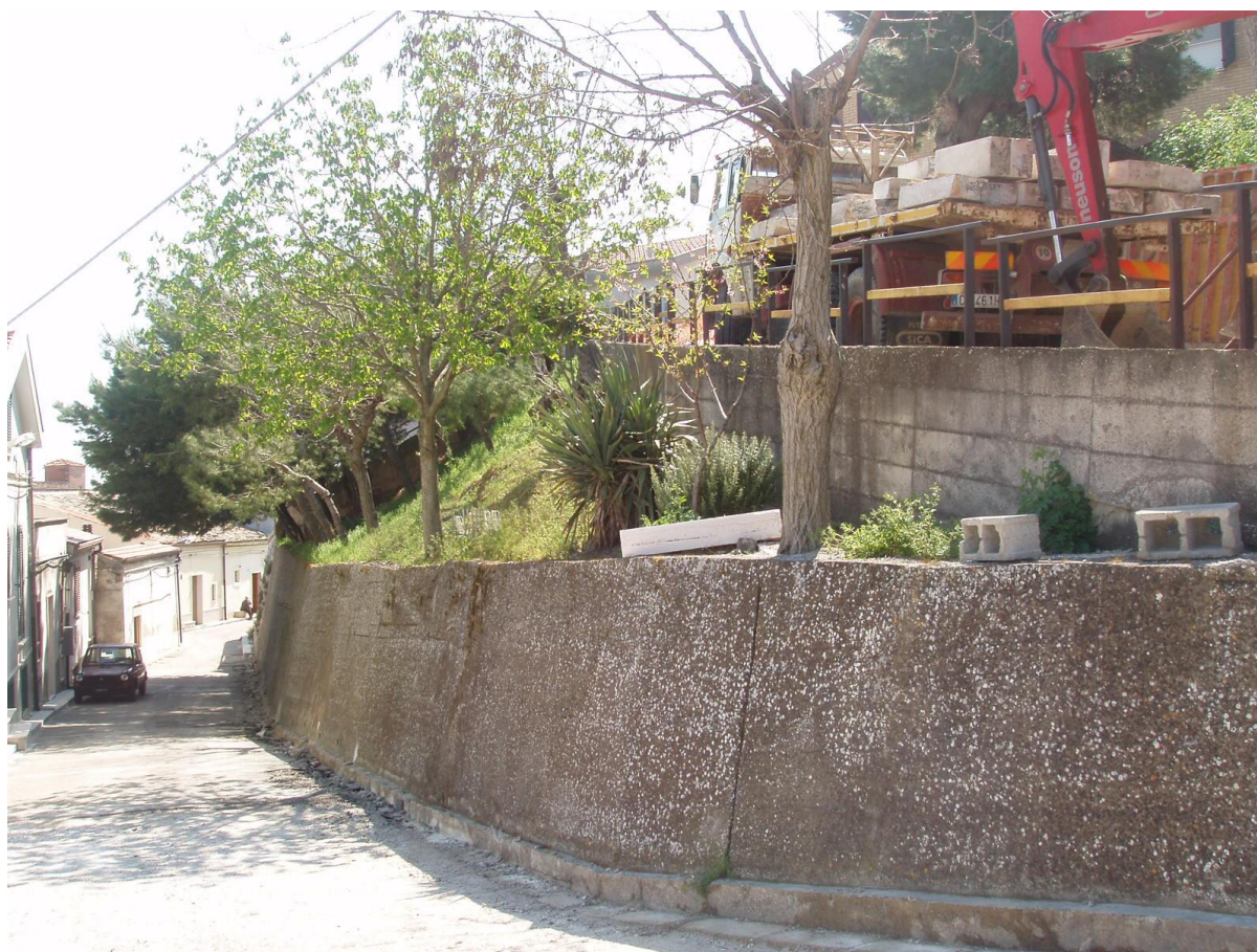
Fig. 6. Vista del muro in c.a. di via San Rocco dissestato, oggetto dell'intervento di consolidamento (Foto aprile 2009)
