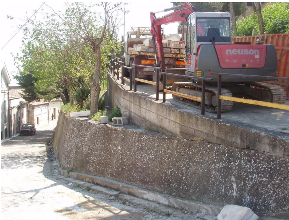
Fig. 12. Vista del tratto iniziale del muro di sostegno in c.a. dissestato di via San Rocco da consolidare con contromuro su micropali e tiranti. (Foto aprile 2009)
