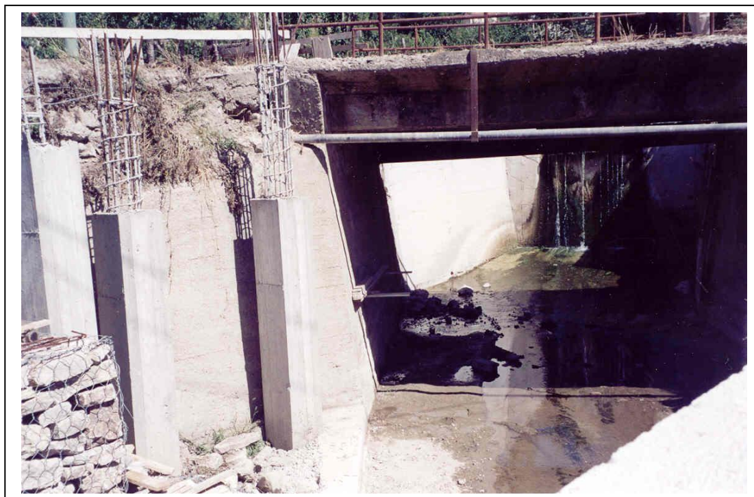
Foto 6. Intervento di consolidamento e rifacimento delle strutture in c.a. degradate del ponte (Foto ottobre 2002)
