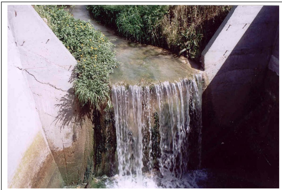
Foto 10. Particolare della zona della piccola cascatella, a monte del ponte, interessata da lavori di pulizia in alveo, taglio della vegetazione e costruzione di muri in c.a.. e posa di una grossa lastra di pietra al piede del salto per smorzare l’energia cinetica delle acque (Foto maggio 2004)
