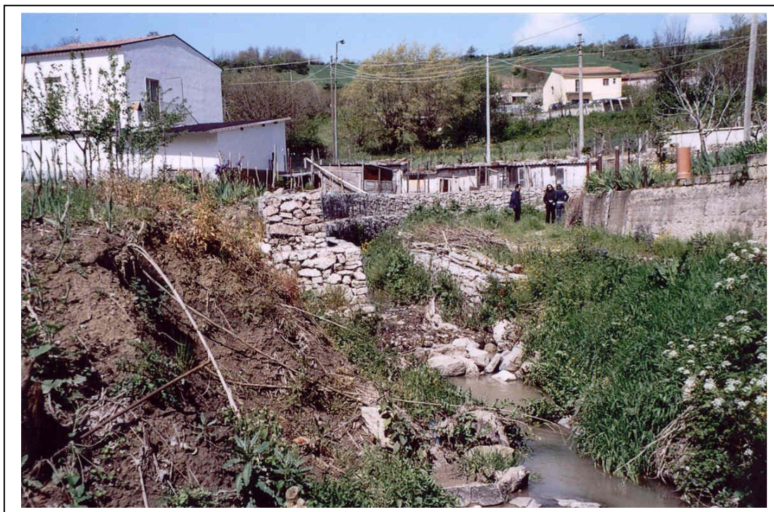
Foto 5. Panoramica della sponda in destra idrografica, nel tratto immediatamente a valle della zona interessata dai lavori di consolidamento e sistemazione idraulica. In primo piano si notano i fenomeni franosi che si sono verificati sulla sponda non protetta nell’inverno - primavera del 2003 - 2004 (Foto maggio 2004)
