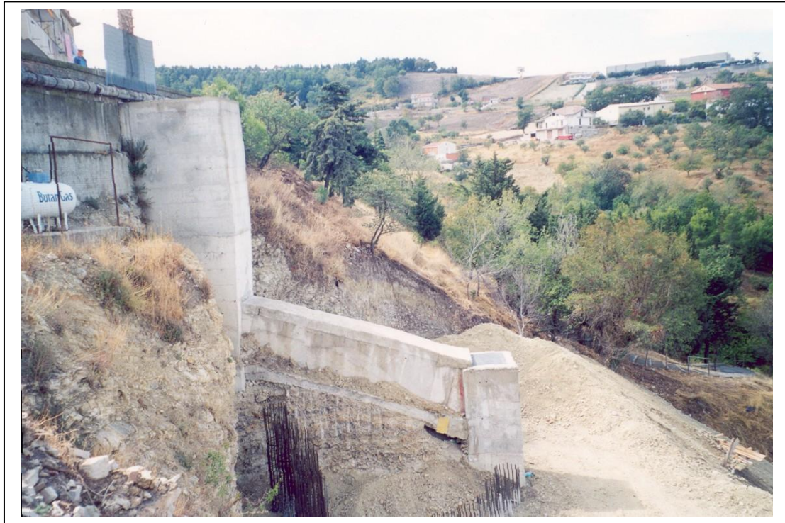
Figura 7: Muro di contenimento dissestato, costruito in c.a. a sostegno della struttura stradale di Via Ripa Cavallina. Alla base del muro è ubicato lo sbocco della condotta di scarico, realizzata con fondi della Protezione Civile in un primo intervento urgente di mitigazione dei rischi idrogeologici. (Foto scattata a Settembre 2001)
