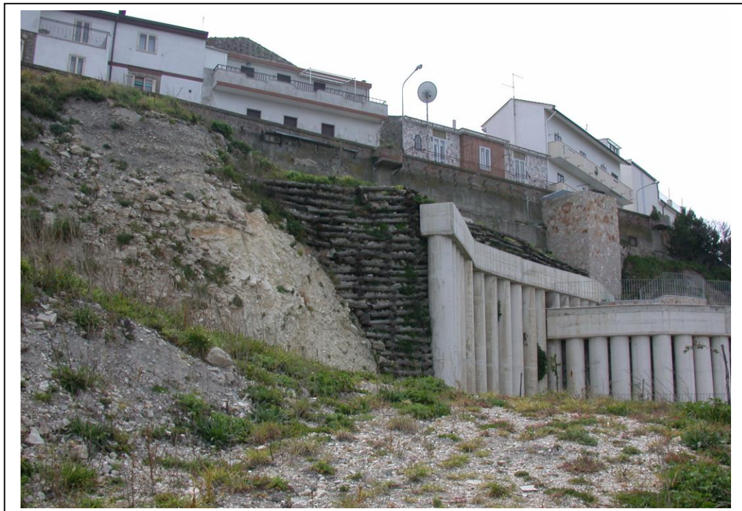
Figura 13: Palificate di sostegno realizzate per il consolidamento della parte alta del pendio e delle strutture di sostegno di Via Ripa Cavallina. La parte di scarpata in roccia calcarea – calcarenitica intensamente frantumata tra la palificata ed il muro esistente è stata protetta da una palificata in legname. (Foto scattata ad Aprile 2003)
