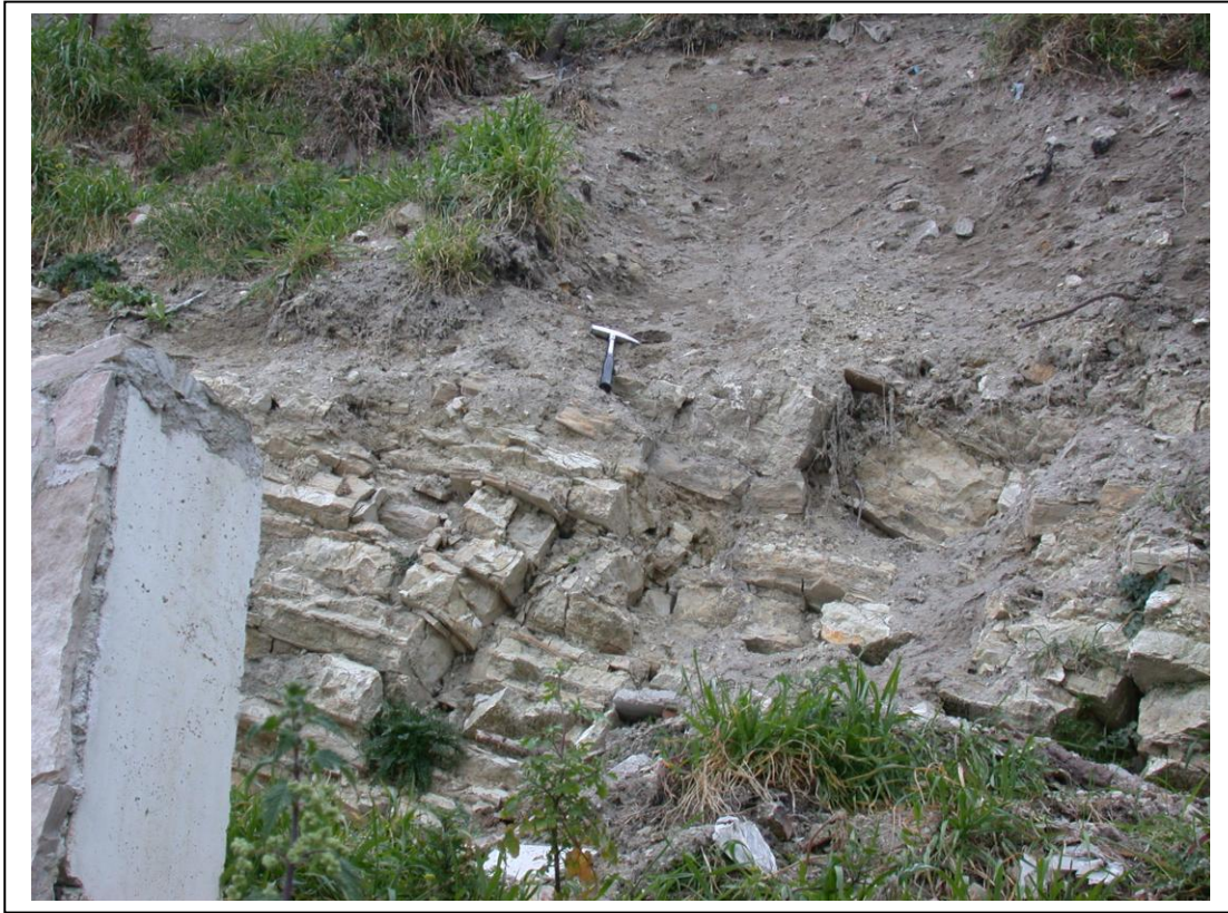
Figura 3: Particolare delle alternanze stratificate calcareo – argilloso – marnose del Flysch di Faeto e della copertura di materiale detritico ed eluvio – colluviale instabile che ricopre il pendio sottostante il muro di sostegno di Via Ripa Cavallina sul lato ovest. (Foto scattata ad Aprile 2003)
